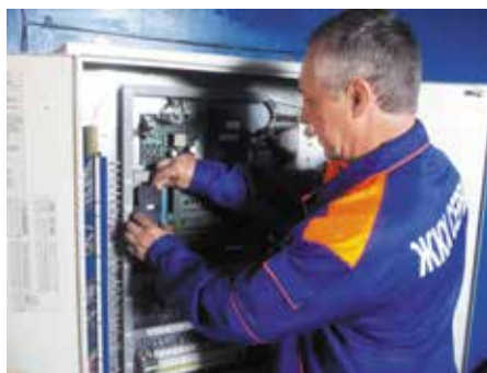
Электромеханик службы по эксплуатации и ремонту лифтового оборудования Сапельников Николай проводит плановый осмотр панели управления лифтом по пр. Менделеева д. 27
