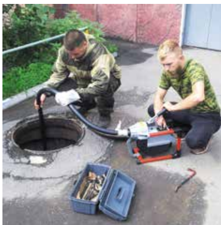
Слесари Жворонков Денис и Гоцкало Денис приступают к прочистке канализационного выпуска по ул. Нефтезаводская, 8
